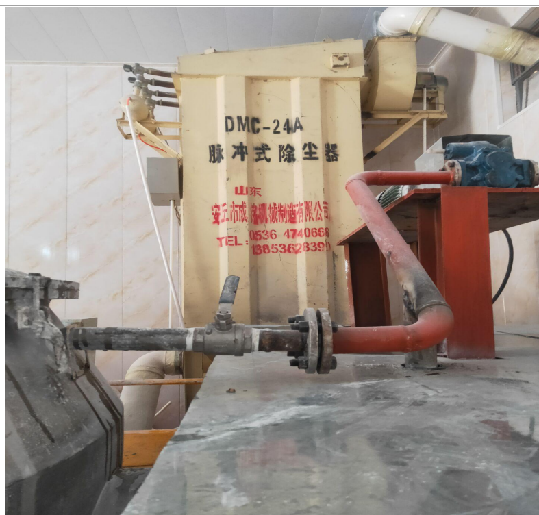
图 3-2 布袋除尘器图（投料机/高速混合一体机产生的粉尘）
