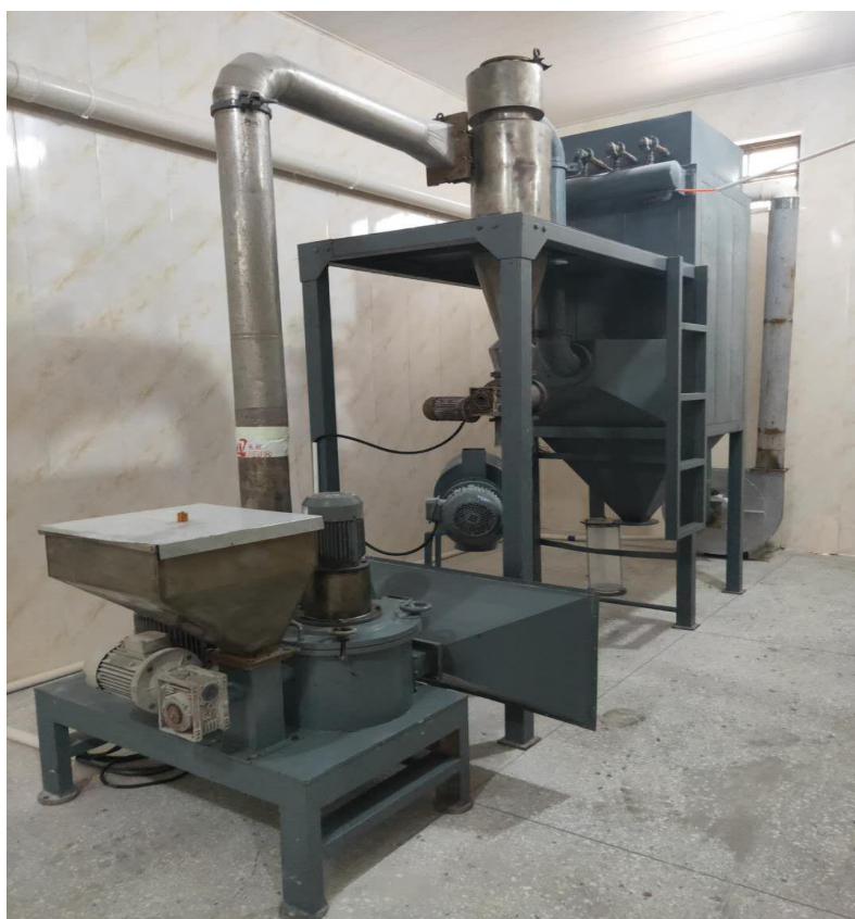
图 3-3 布袋除尘器图（磨粉设备产生的粉尘）
