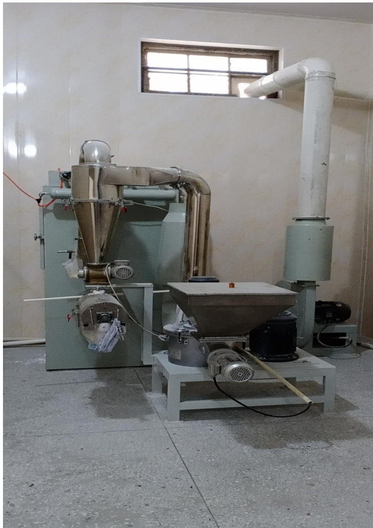
图 3-1 布袋除尘器图（磨粉设备产生的粉尘）
